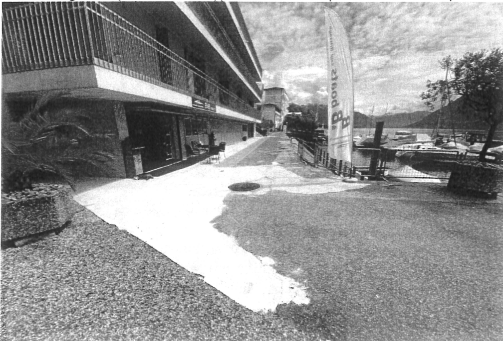
ill. n. 2 Dettaglio della pavimentazione rappazzata e barriere di protezione anti-caduta provvisorie.
