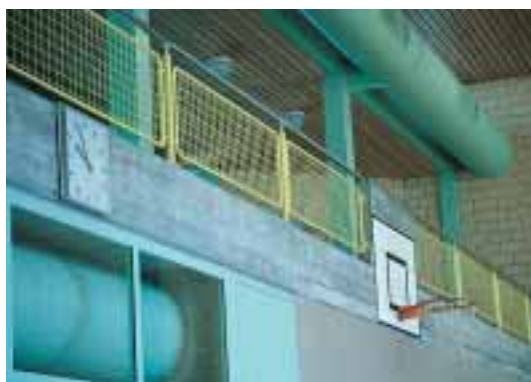
Protezione contro le cadute: rete d'armatura o rete metallica a maglie diagonali, larghezza delle maglie mass. 4 cm, altezza min. 1.1 m
