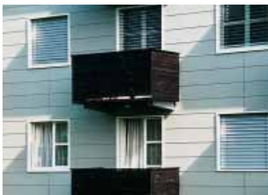
Palazzo moderno: facciata in lastre di fibrocemento, balconi con parapetti costituiti da tavole di legno disposte in modo da non potersi arrampicare
