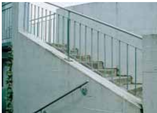
Scala con più di 5 gradini: ringhiera costituita da aste verticali con corrimano per appoggiarsi
