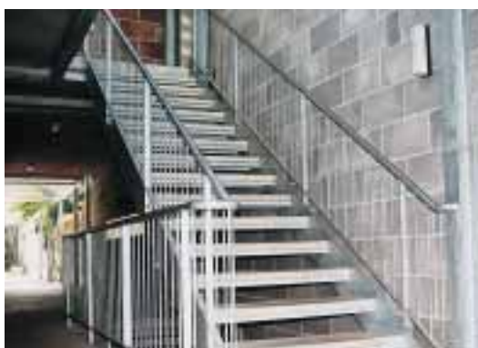
Scala di metallo aperta: ringhiera in metallo costituita da aste verticali, aperture tra i gradini e tra le aste della ringhiera inferiori a \varnothing 12 cm
